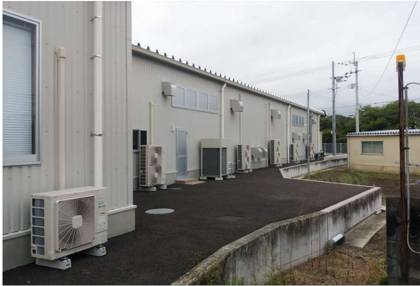
(現状の室外機設置写真)
