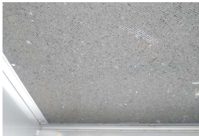
フード内フィルター汚れ
