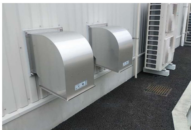
外部給気用フード(2か所)
